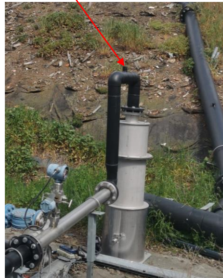
Figure 2 : point de piquage : entrée unité de valorisation (flèche rouge)
